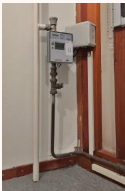
De energiemeter op de verwarming
